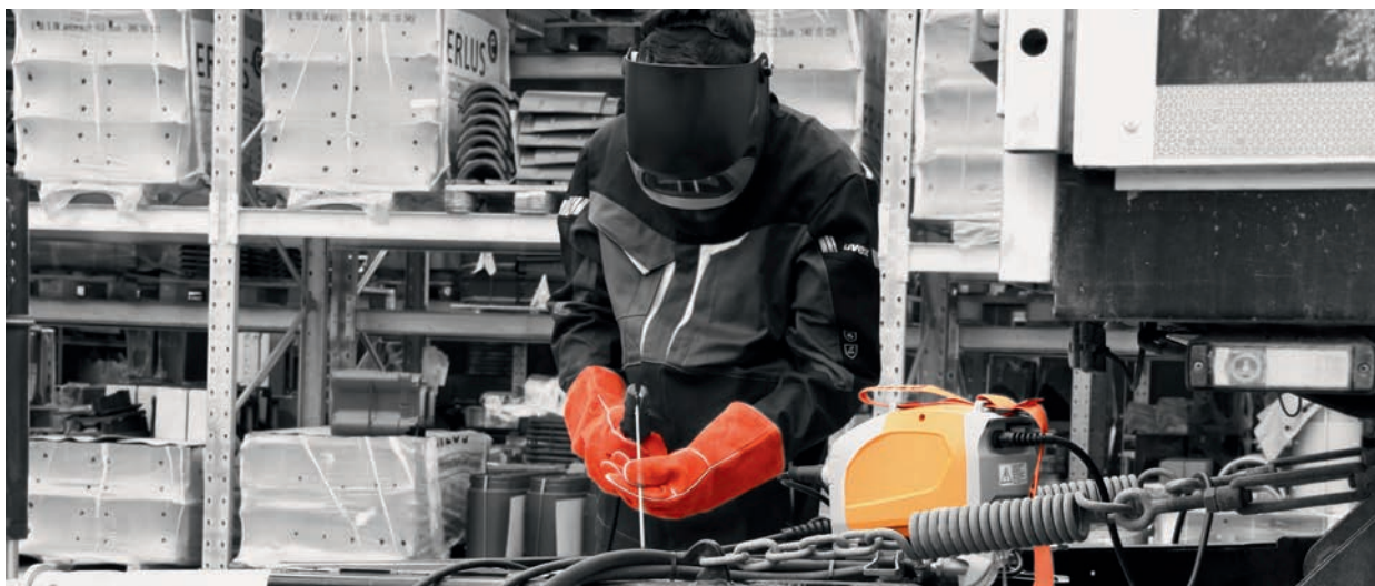
BOOSTER2 tijdens gebruik bij een reparatie. Altijd betrouwbaar en klaar voor gebruik.
